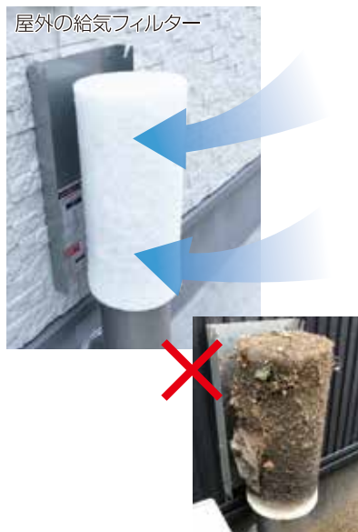
屋外の給気フィルター
